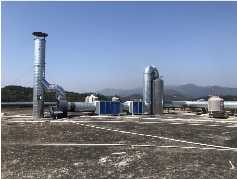
图 4-4 废气处理设施图
