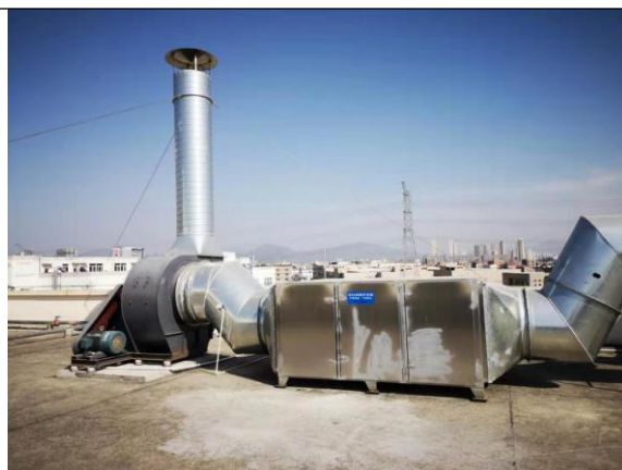
2号楼废气处理设施局部图
