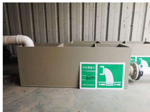
3号楼废水排放口标识牌
