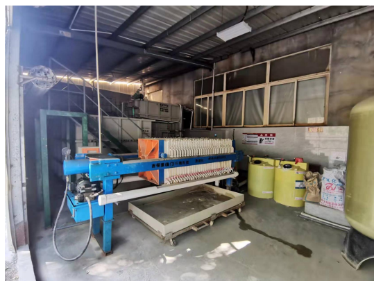
3号楼废水处理设施局部图
