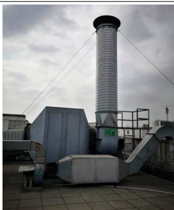
1号楼废气处理设施局部图
