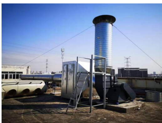
3号楼废气处理设施局部图
