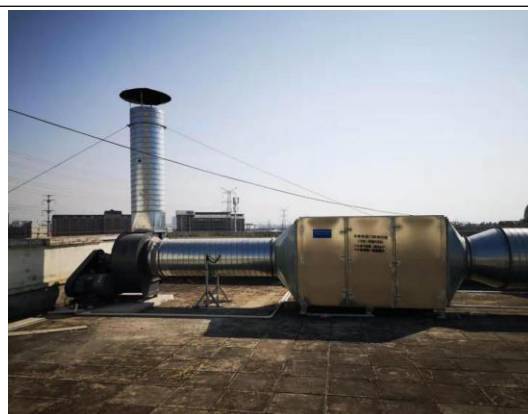
4号楼废气处理设施局部图
