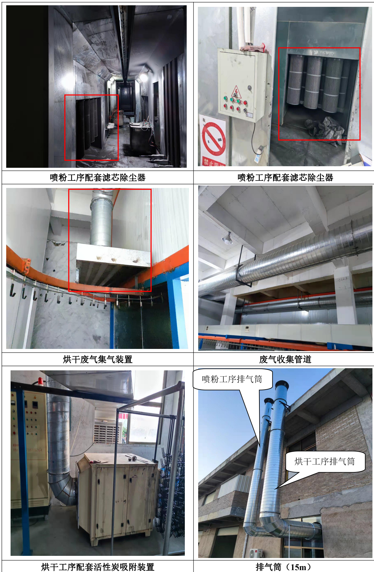
图 4-3 项目废气处理设施现场照片
