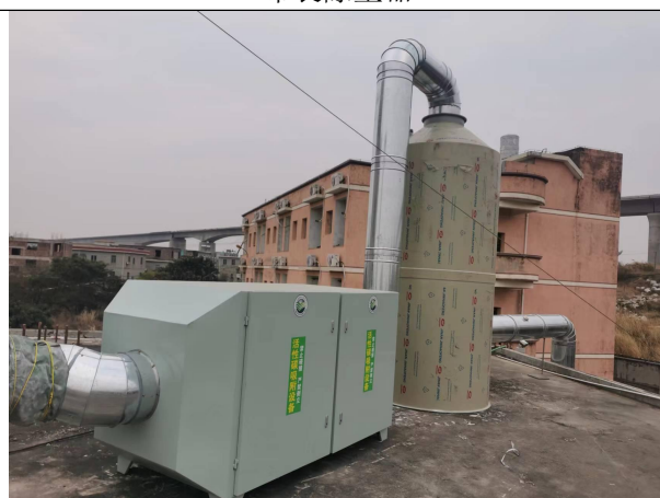
水喷淋+活性炭吸附装置
