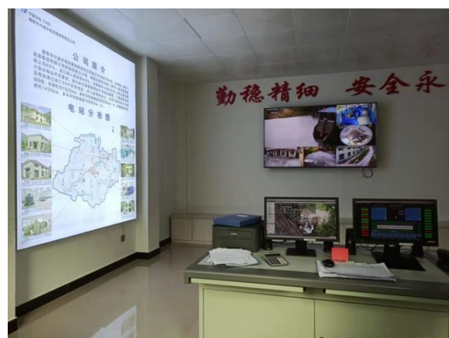
集控中心（下泄流量监控）
