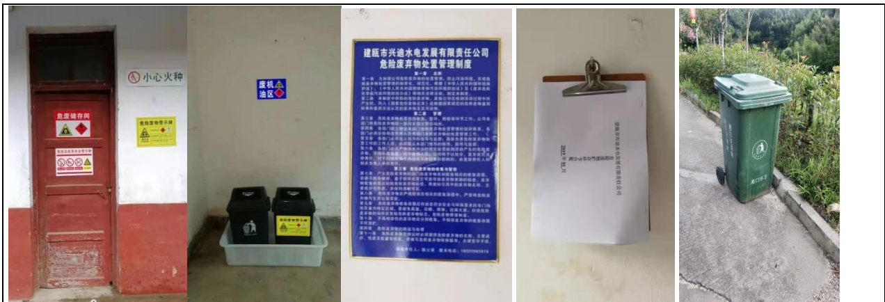
图6.5-2 危废暂存间、垃圾收集桶等固废暂存设施
