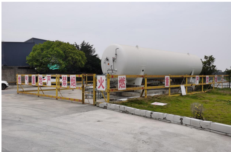
LNG 撬装站地面硬化、防护栏及警示标志
