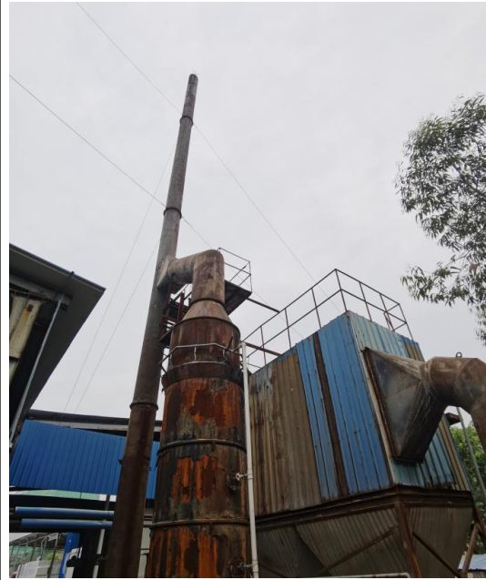
备用生物质燃料锅炉废气排气筒
