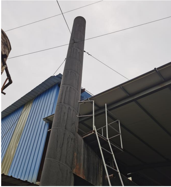
天然气锅炉废气排气筒
