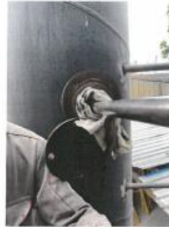
Q2 天然气锅炉废气排放口
