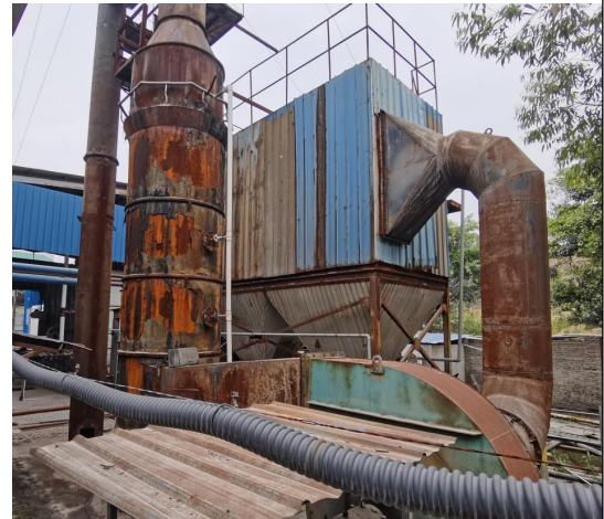
循环喷淋塔（左）、多管除尘器（右）
