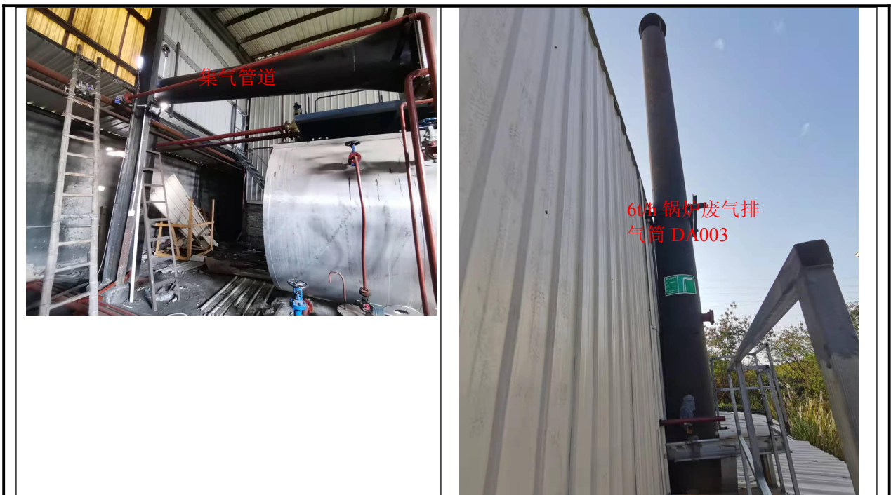
图 3-2 项目废气处理设施图
