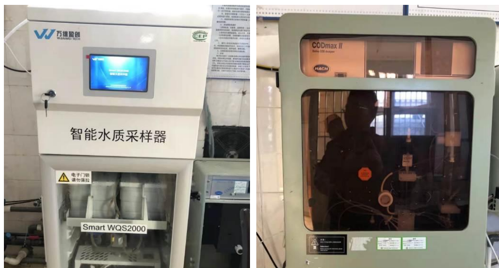
图4.2.2 污水排放口在线监控装置
