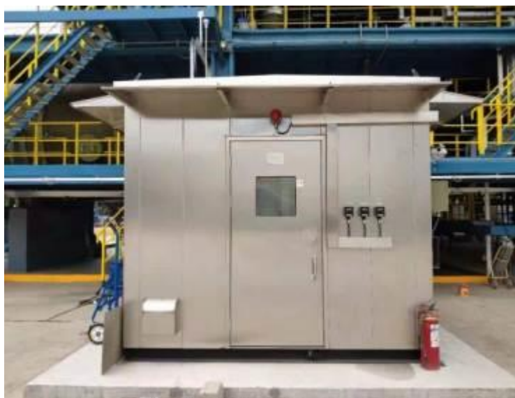
图4.2.3 废酸再生焚烧炉排放口在线监测设备房
