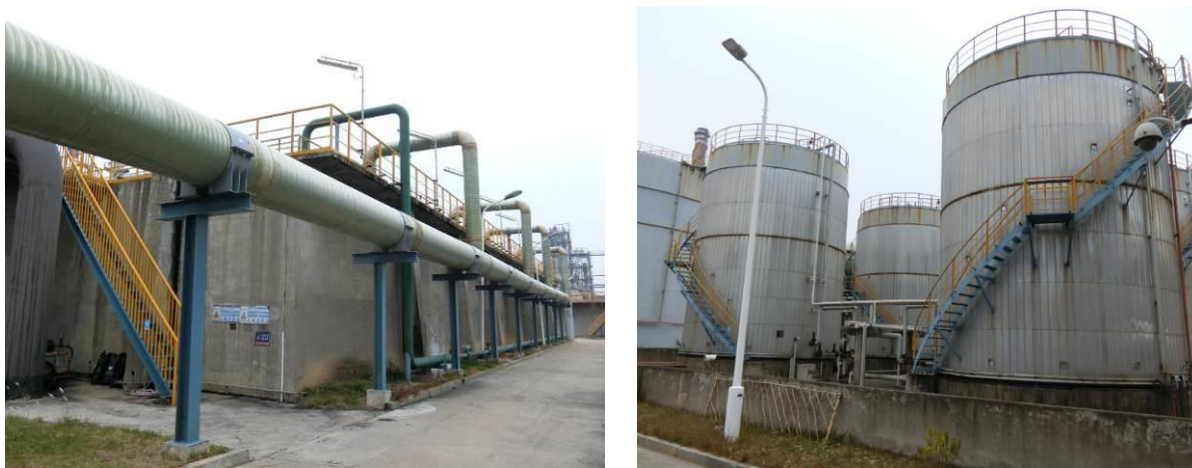
图 4.1.5 含盐污水处理站设施图
