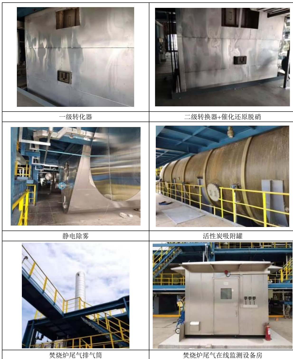
图 4.1.7 焚烧炉尾气排放设施图
