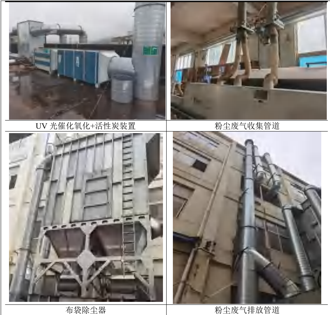
图3.2-3 相关废气处理设施照片
