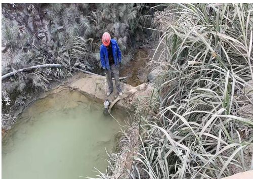
图 5 雨污水沉淀池固定泵
