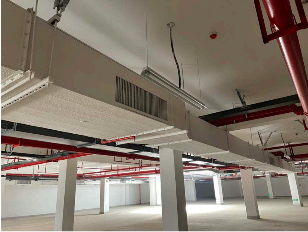
地下室通风系统
