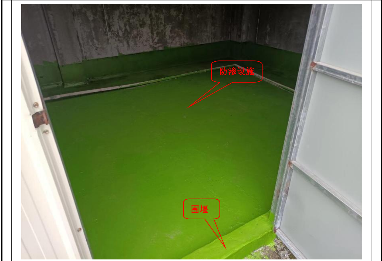
图片 2 危险废物暂存场所防渗和围堰措施
