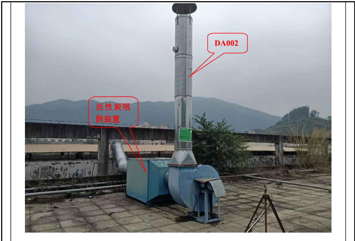
图片 2 注浆及搅拌废气处理设施
