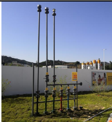
油罐油气排放装置
