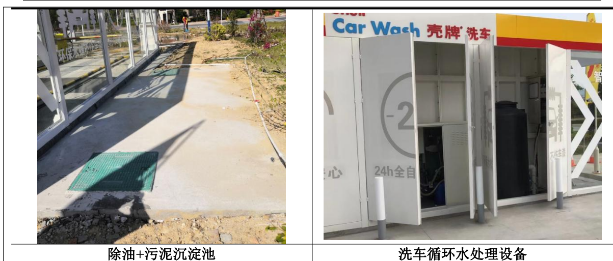
图 3.1.4 污水处理设施照片
