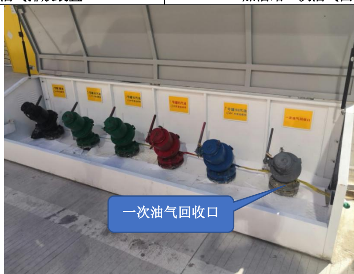
加油站一次油气回收口
