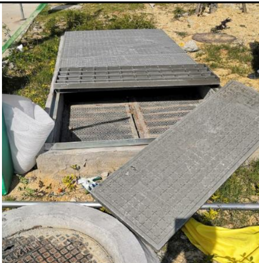
地面清洗废水隔油池
