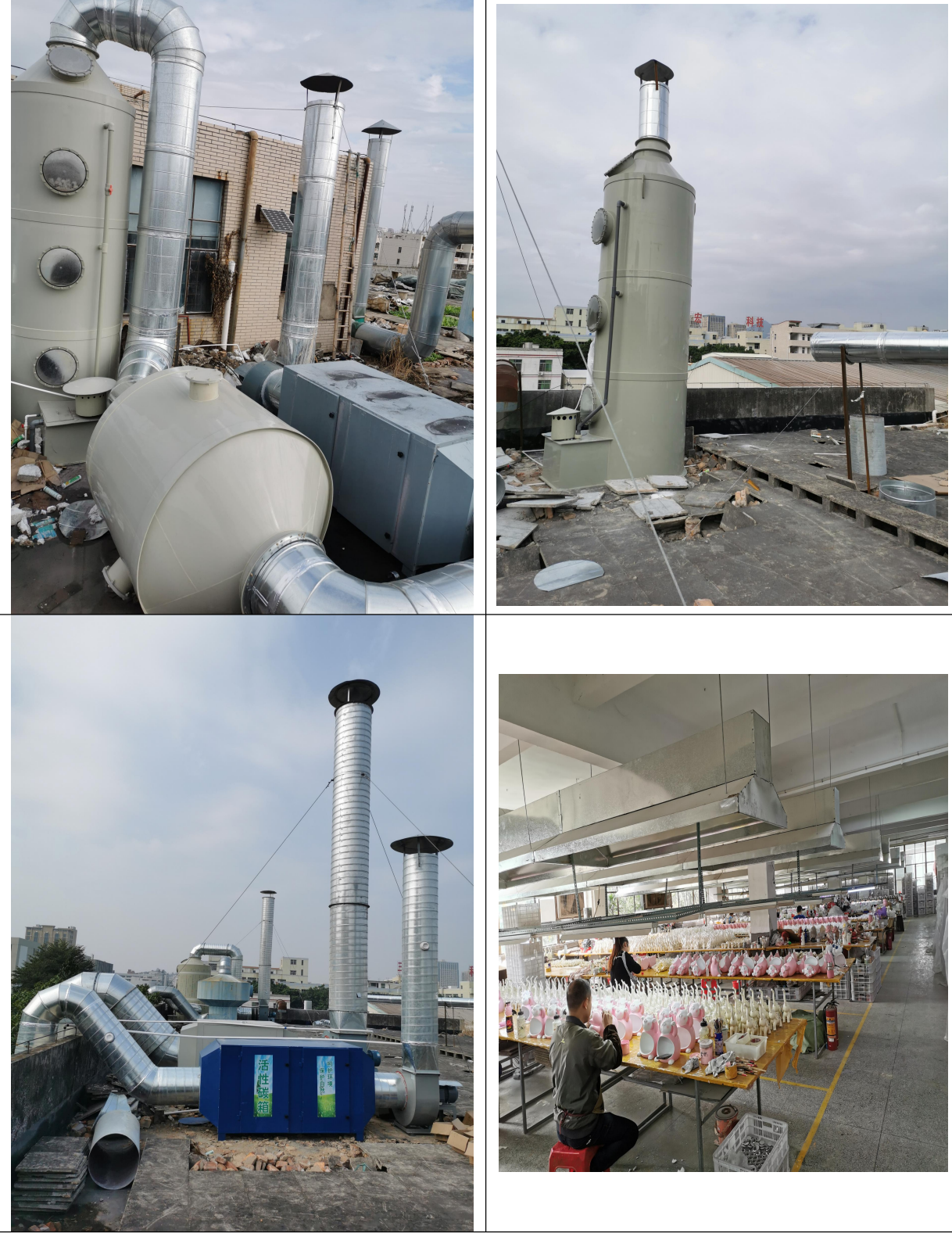
颗粒物、有机废气处理设施及排气筒
