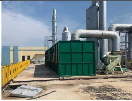
污水处理站废气处理设施
