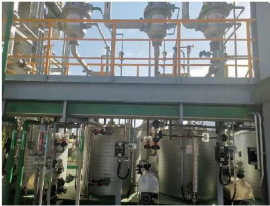
氟化氢处理设施
