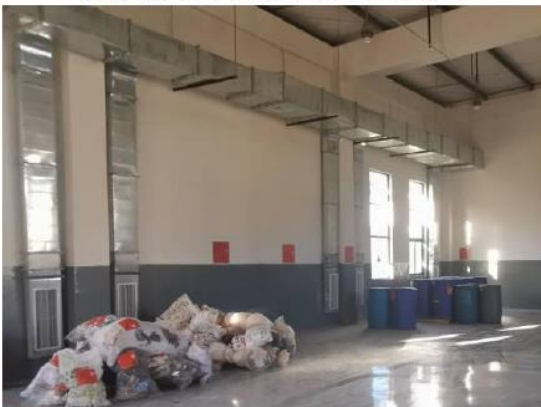
危险废物暂存间废气收集管道
