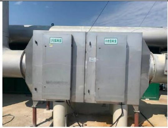
污水处理站废气处理设施
