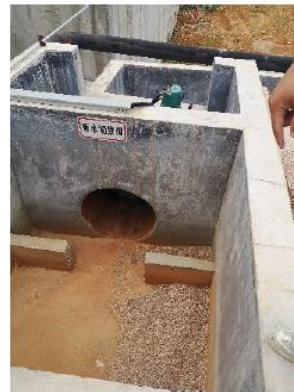
排放口雨水切换阀
