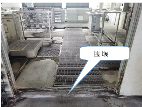
阳极氧化车间围堰
