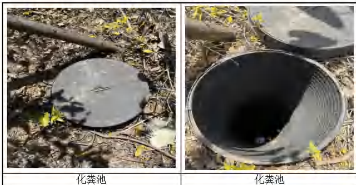
图 4.1-1 废水处理设施
