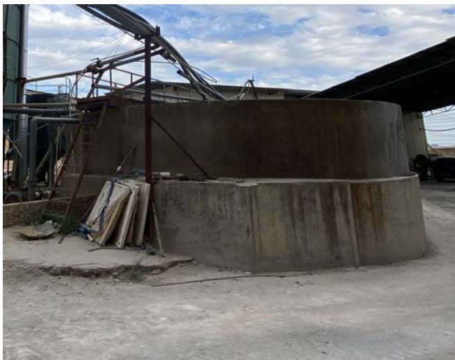
生产废水沉淀设施
