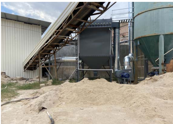
布袋除尘设施
