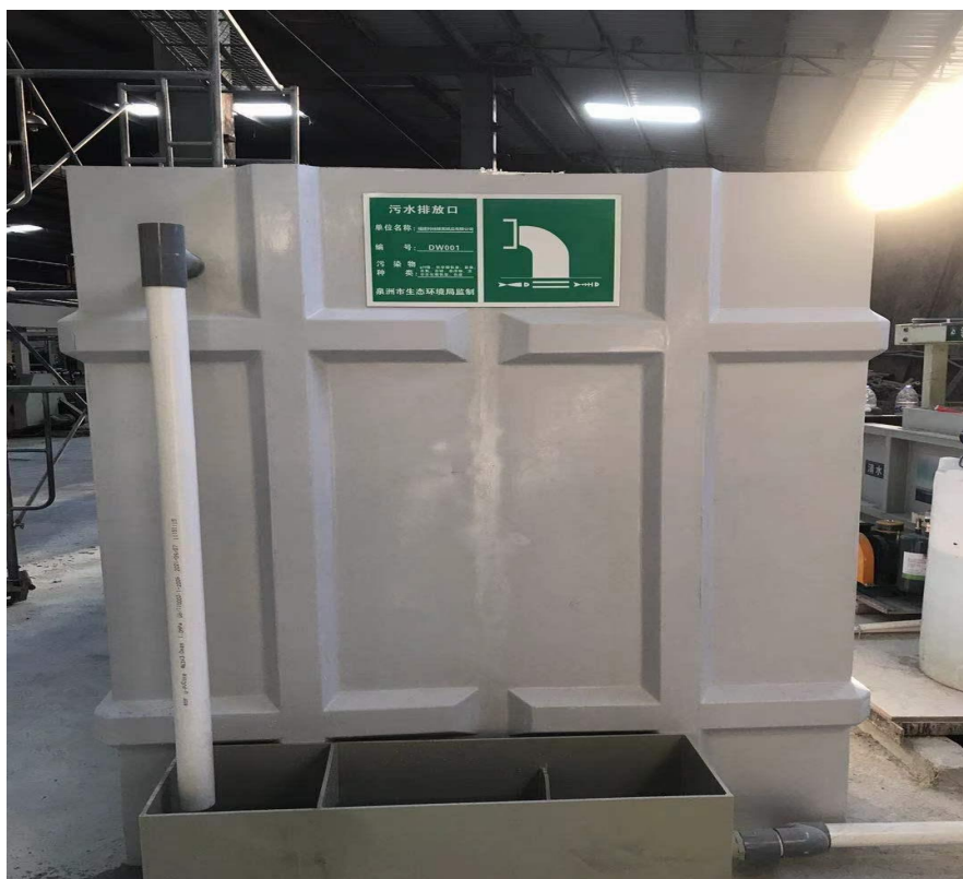
生产废水治理设施
