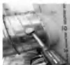
有机废气处理设施PI进口
