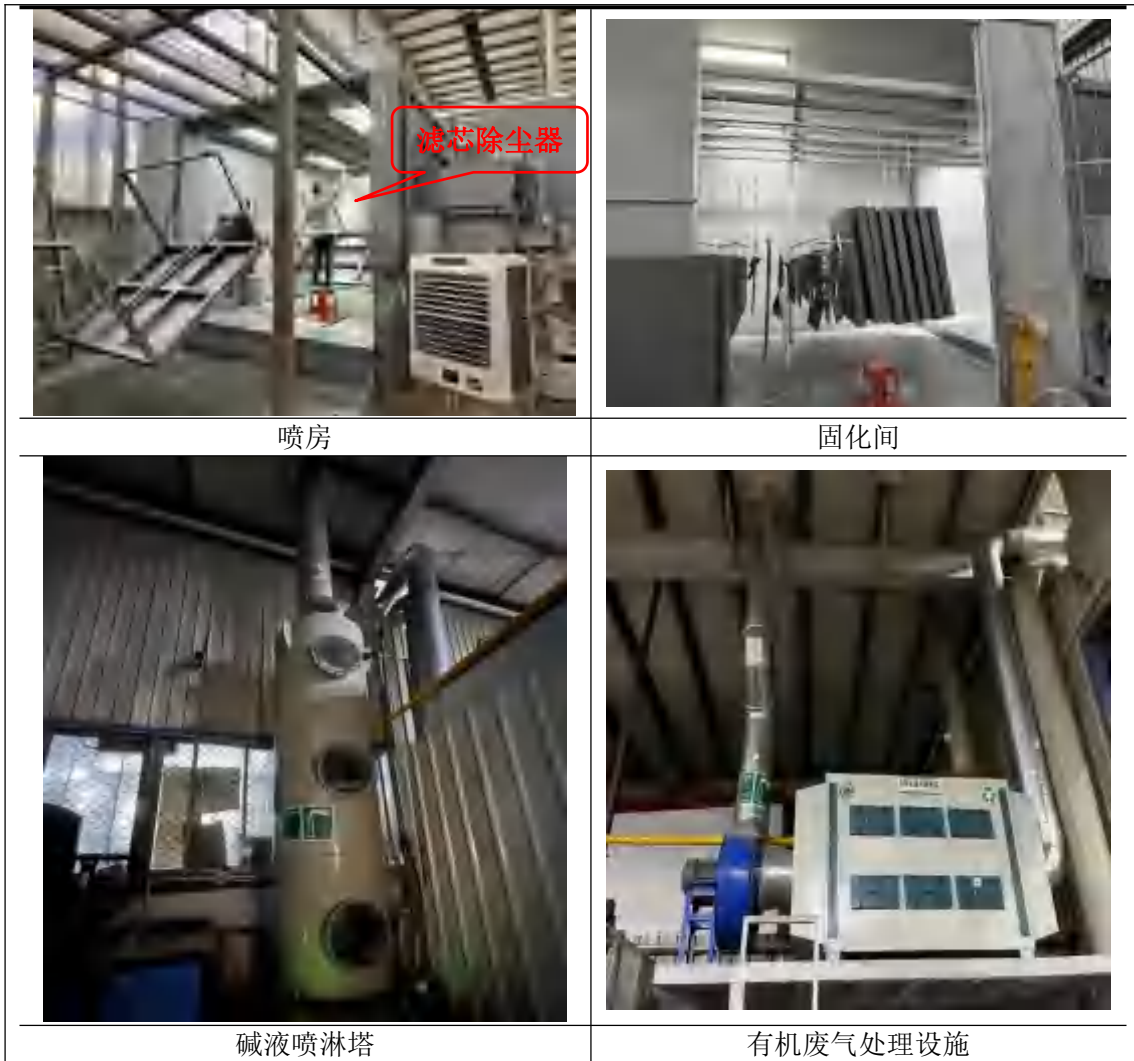
图3.2-3 相关废气处理设施照片
