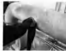
酸雾废气处理设施◎P1 进口
