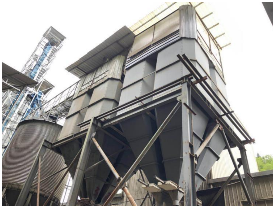
图 2.1-6 废气饲料粉尘处理装置（脉冲布袋除尘器）
