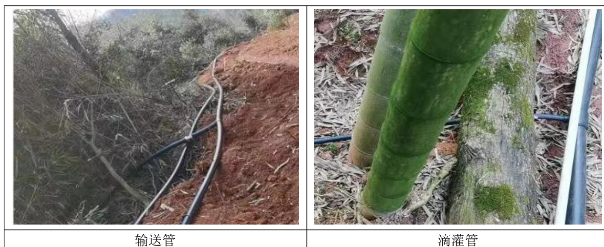
图 2.1-5 污水处理设施和灌溉设施图
