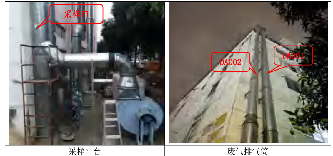
图3.2-3 相关废气处理设施照片
