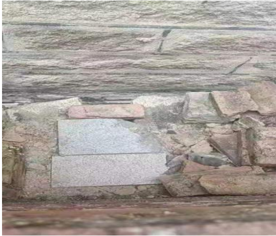
出租方民房化粪池
