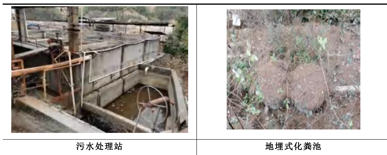
图 4-4 项目废水处理措施照片
