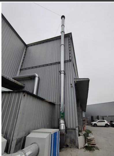
活性炭吸附装置+15m高排气筒
