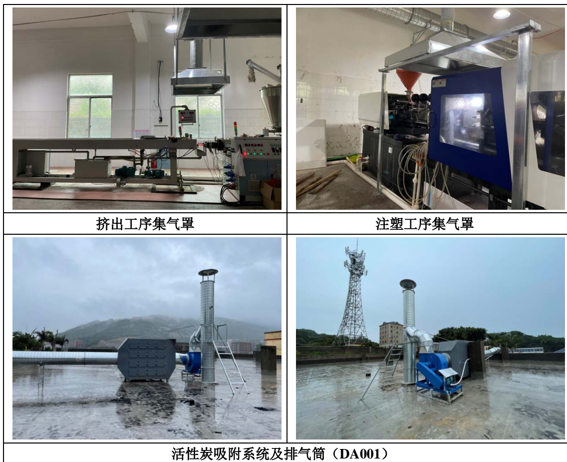
图 4.1-2 废气处理设施照片
