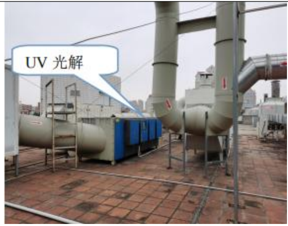
有机废气处理设施
