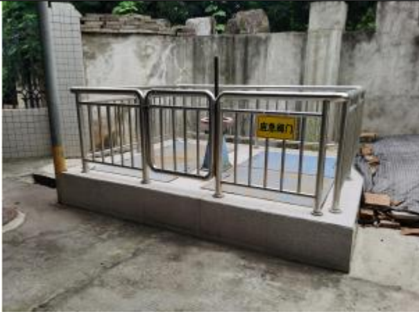
雨水排放口应急阀门
