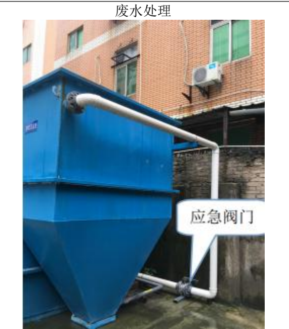
废水处理设施应急阀门
