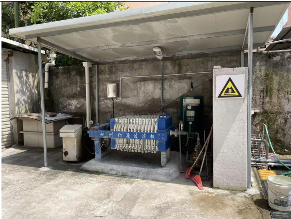
废水处理设施压滤机
