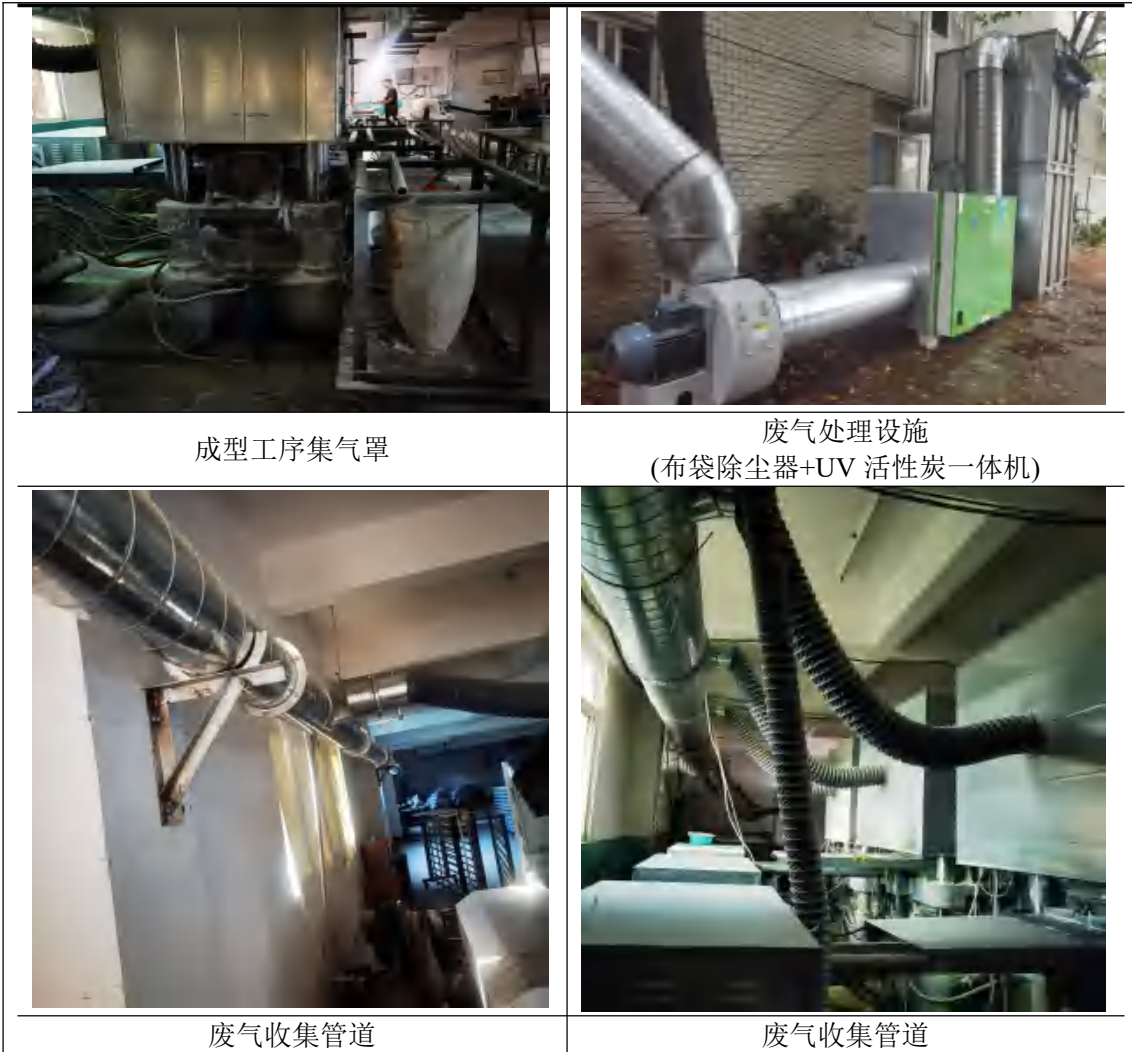
图3.2-3 相关废气处理设施照片
