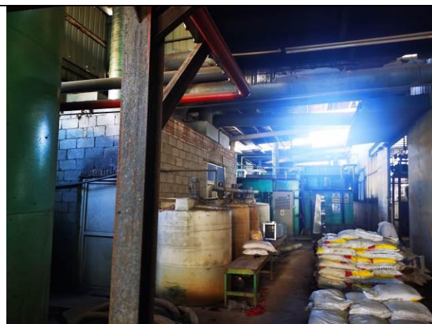
浊废水预处理设施
