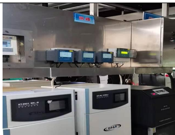
排污口在线监控装置
