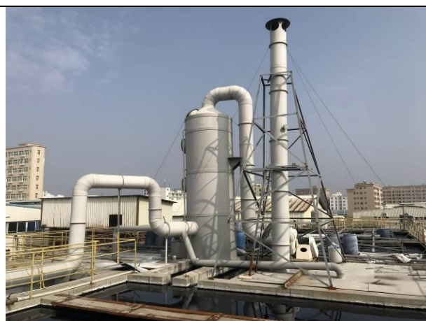
污水处理恶臭处理设施
