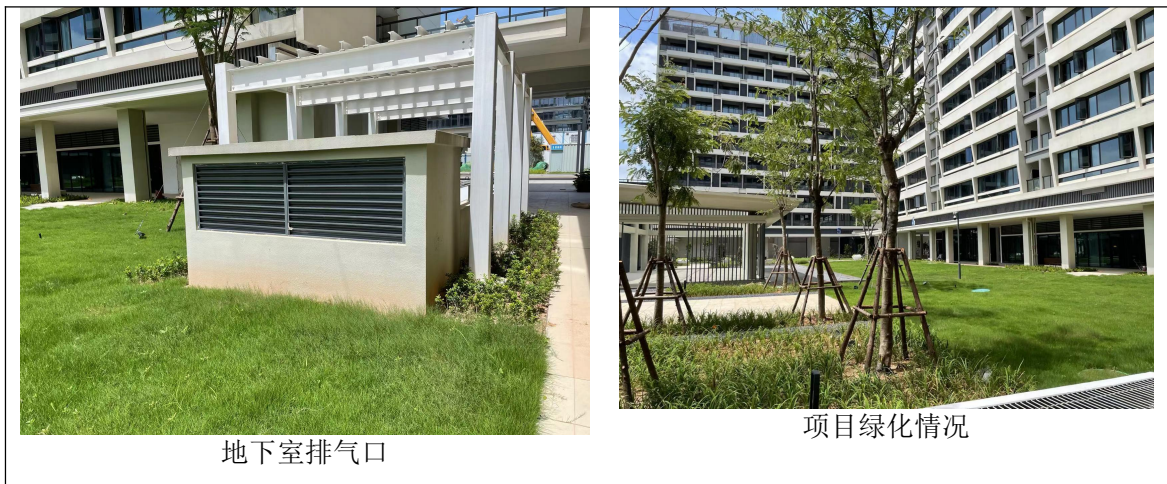
图 4-4 废气设施设置情况现场图
