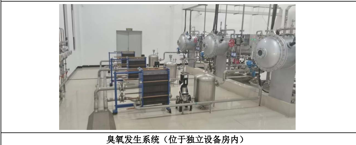
图 4.2-4 废气处理设施照片
