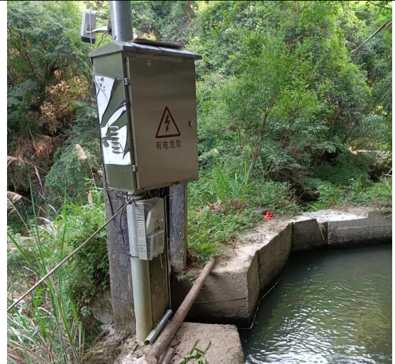
监控设施及下泄流量装置
