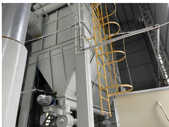
除尘器局部图
