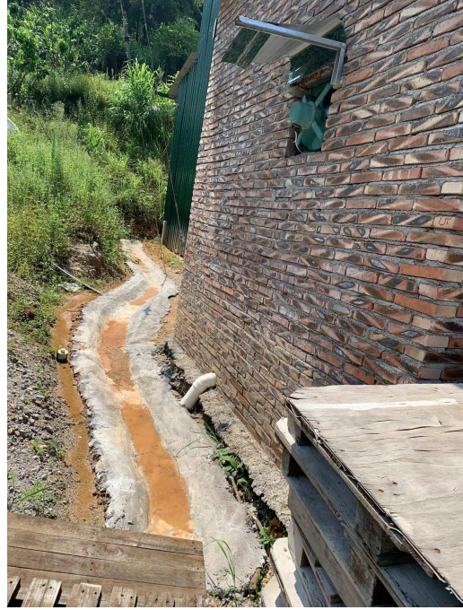
现场雨水管沟局部图
