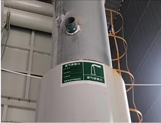
排放口标识牌局部图
