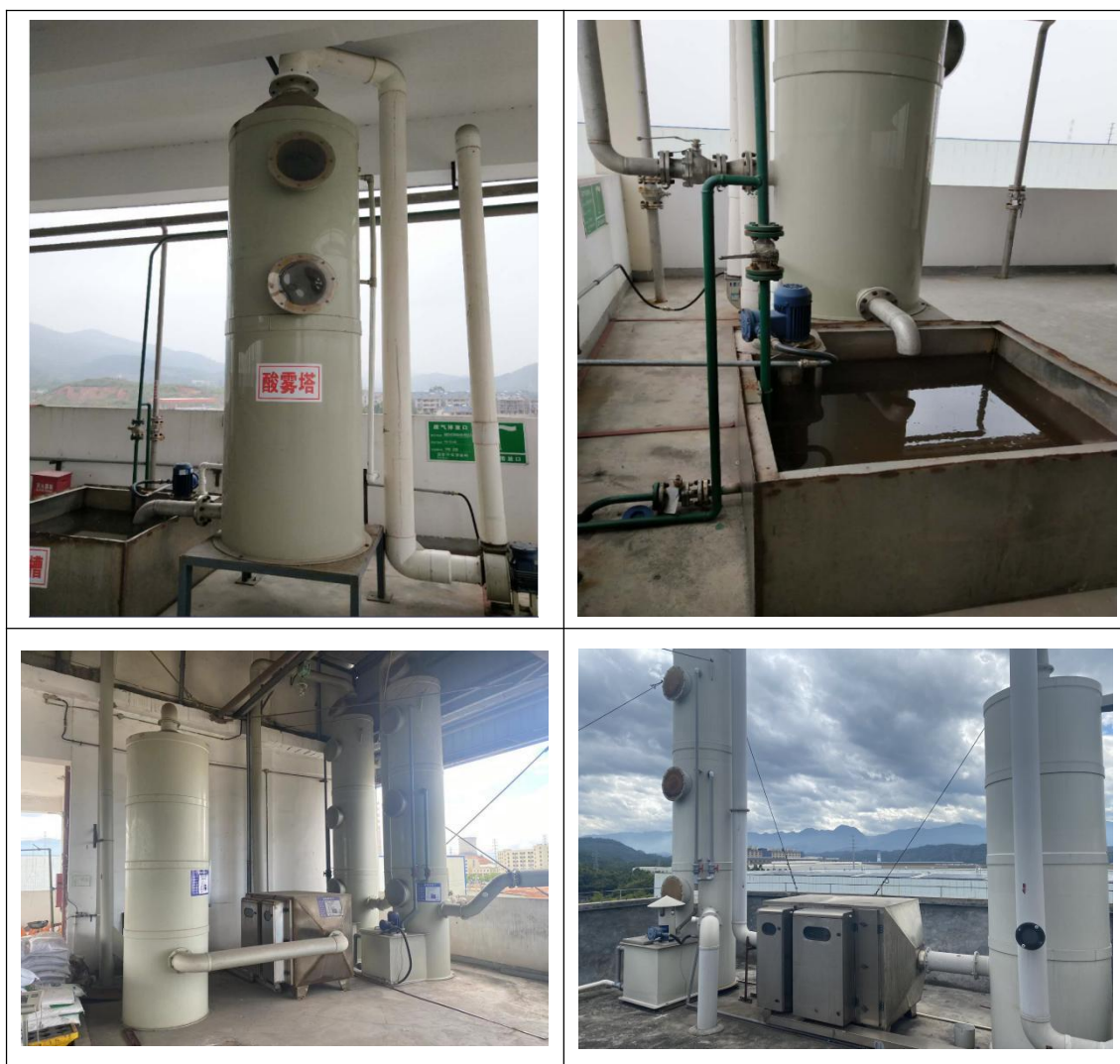
图 4-5 废气处理设施
