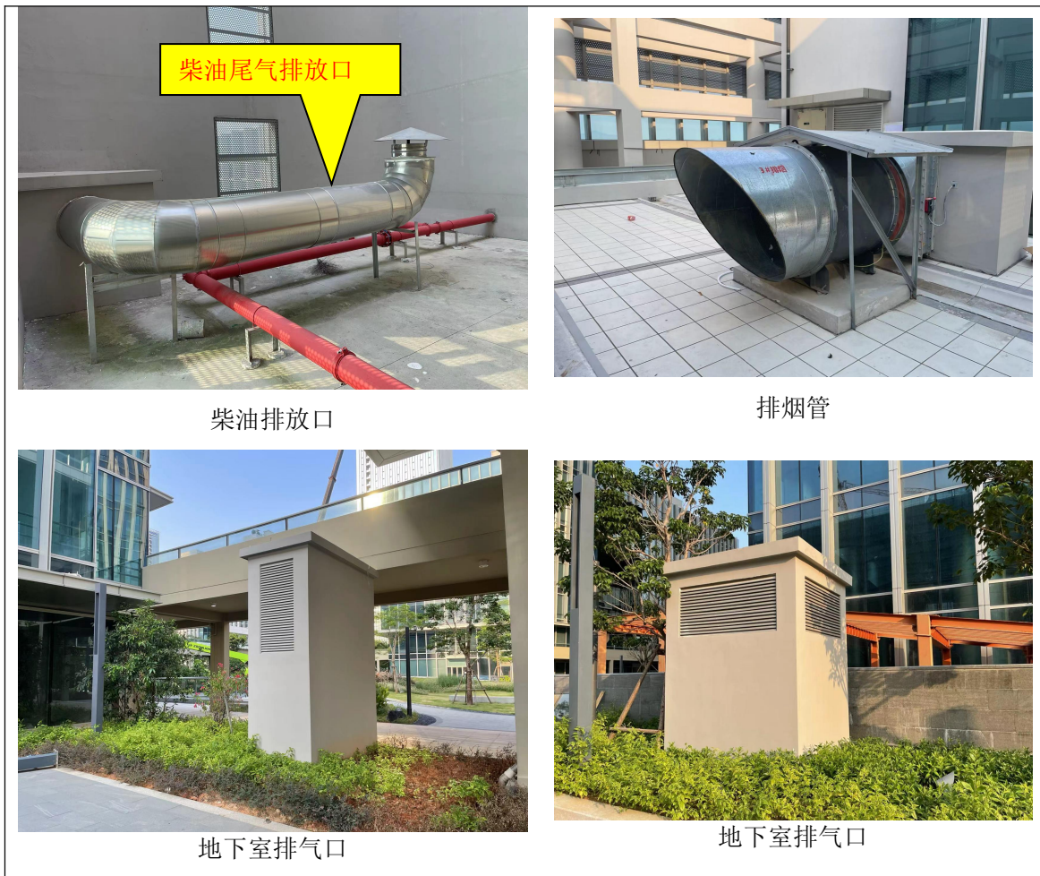
图 4-4 废气设施设置情况现场图
