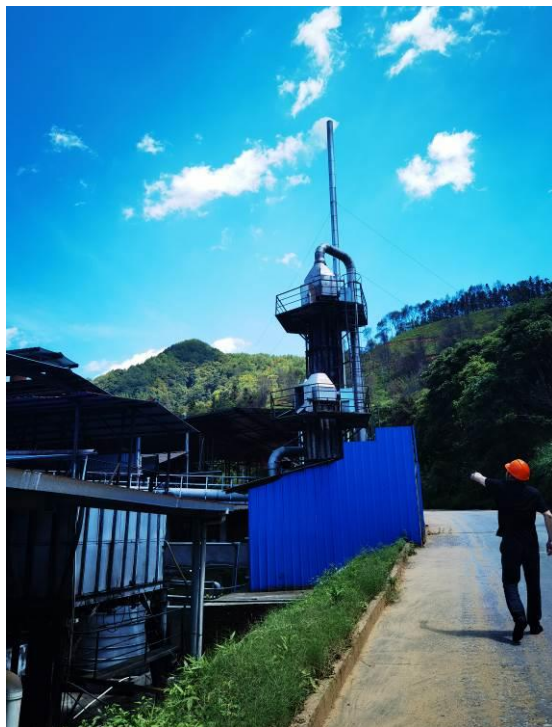
酸回收、漂洗废气处理设施
