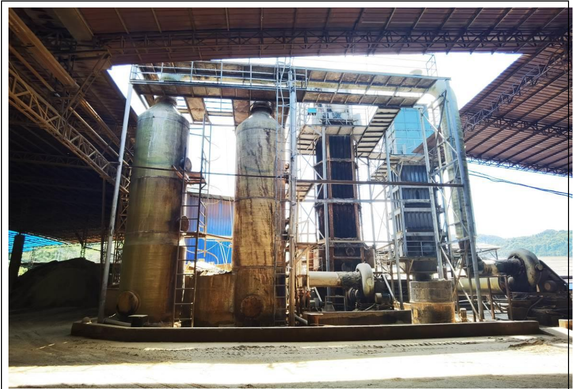
炭化活化废气处理设施
