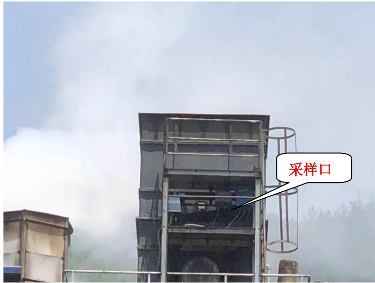
图 3.6-1 炭活化废气排气筒
