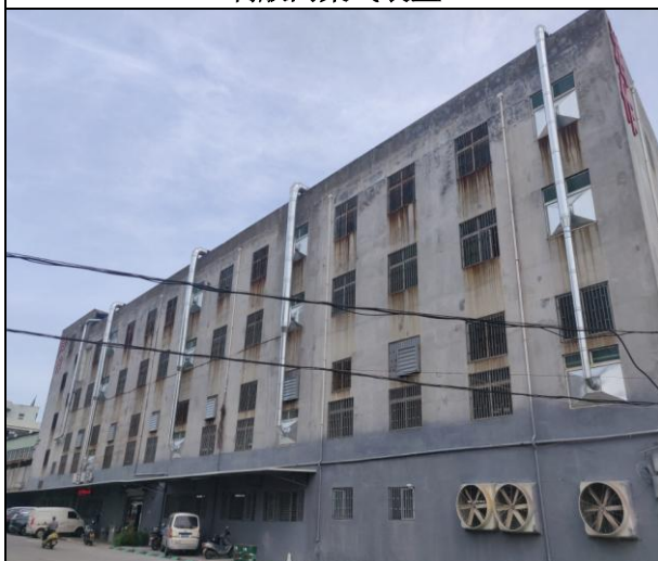
厂房外墙集气管道
