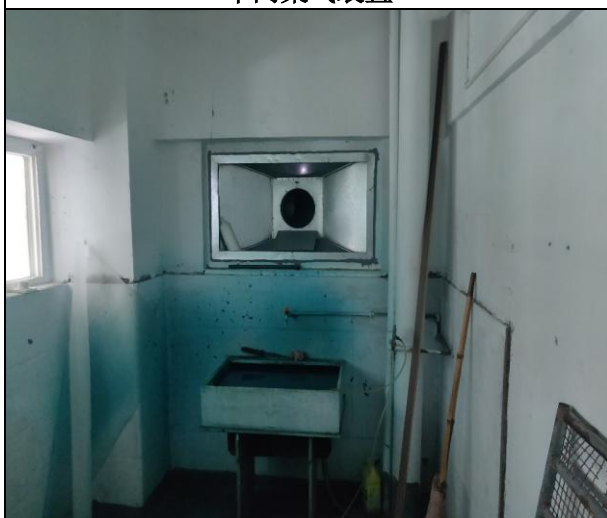
制版间集气装置
