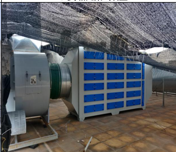
楼顶活性炭吸附装置
