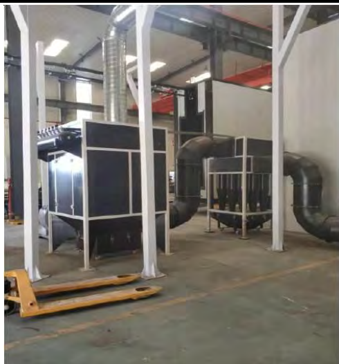
喷粉除尘装置
