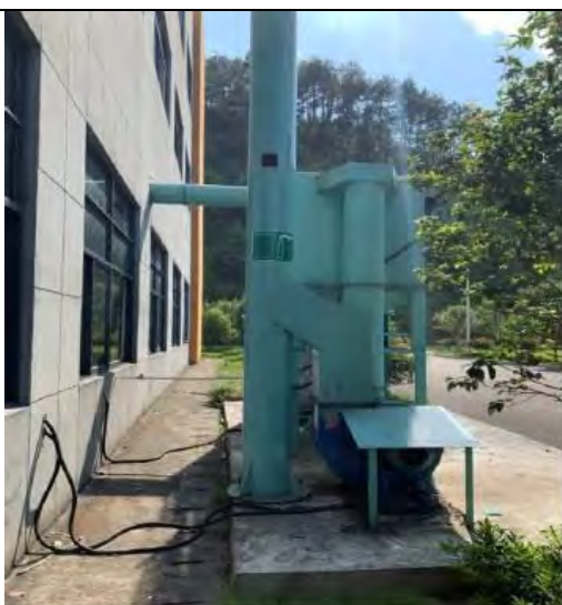
加工中心粉尘废气排放口 DA002
