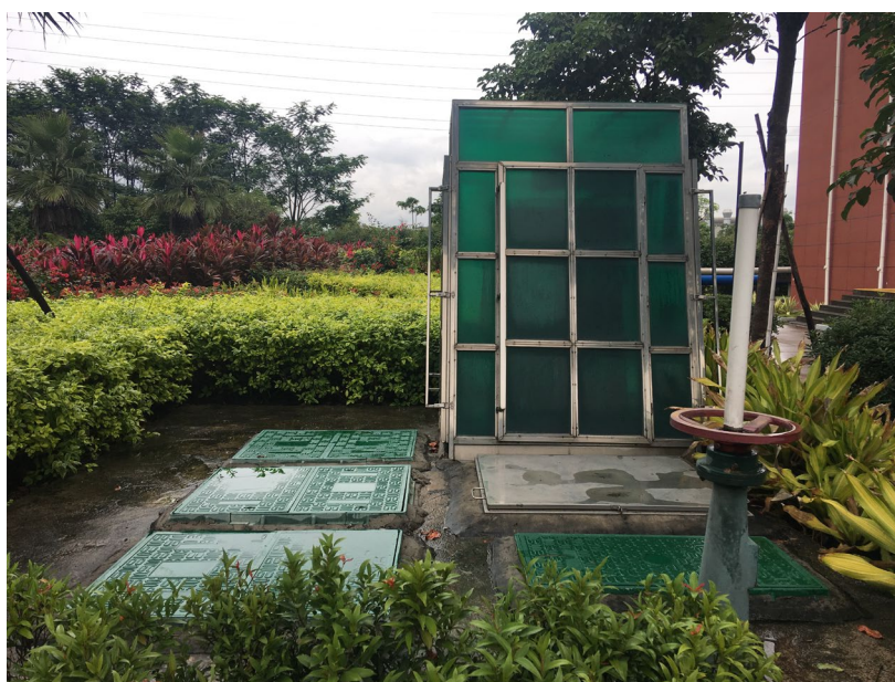
图 3-1 园区污水处理站现场照片
