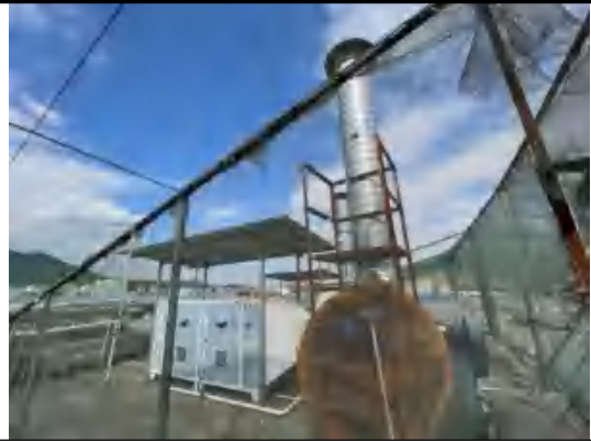
废气处理设施
