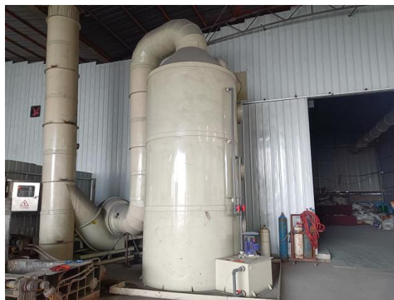
废气治理设施
