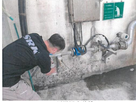
W1 厂区污水总排口
