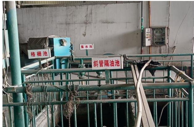
图 4.1-2 污水预处理站
