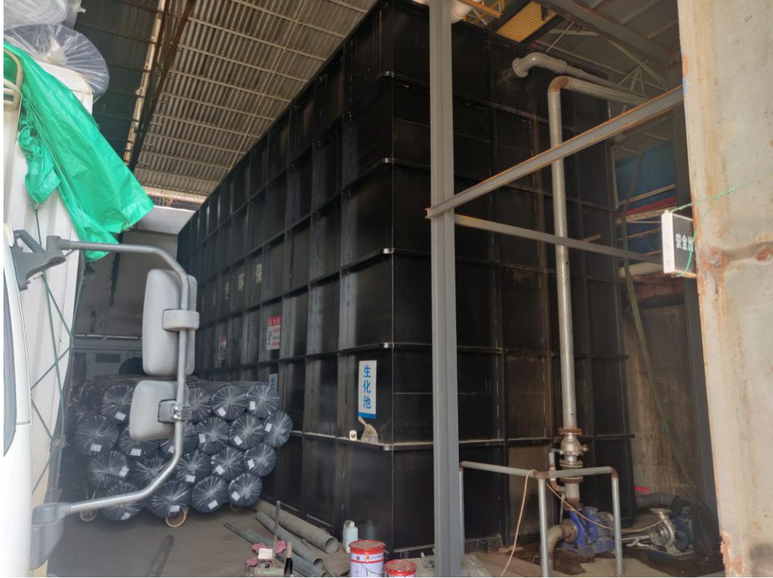
生活污水处理设施
