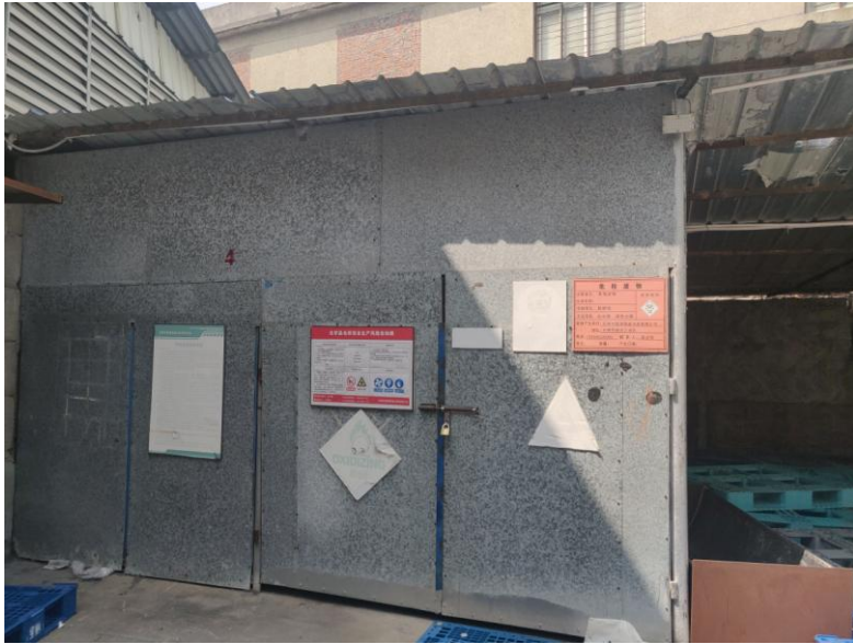
图 3-5 危险废物主要环保措施照片
