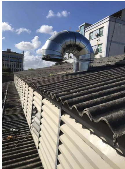
拉毛废气收集设施
