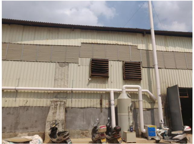
污水站废气处理设施
