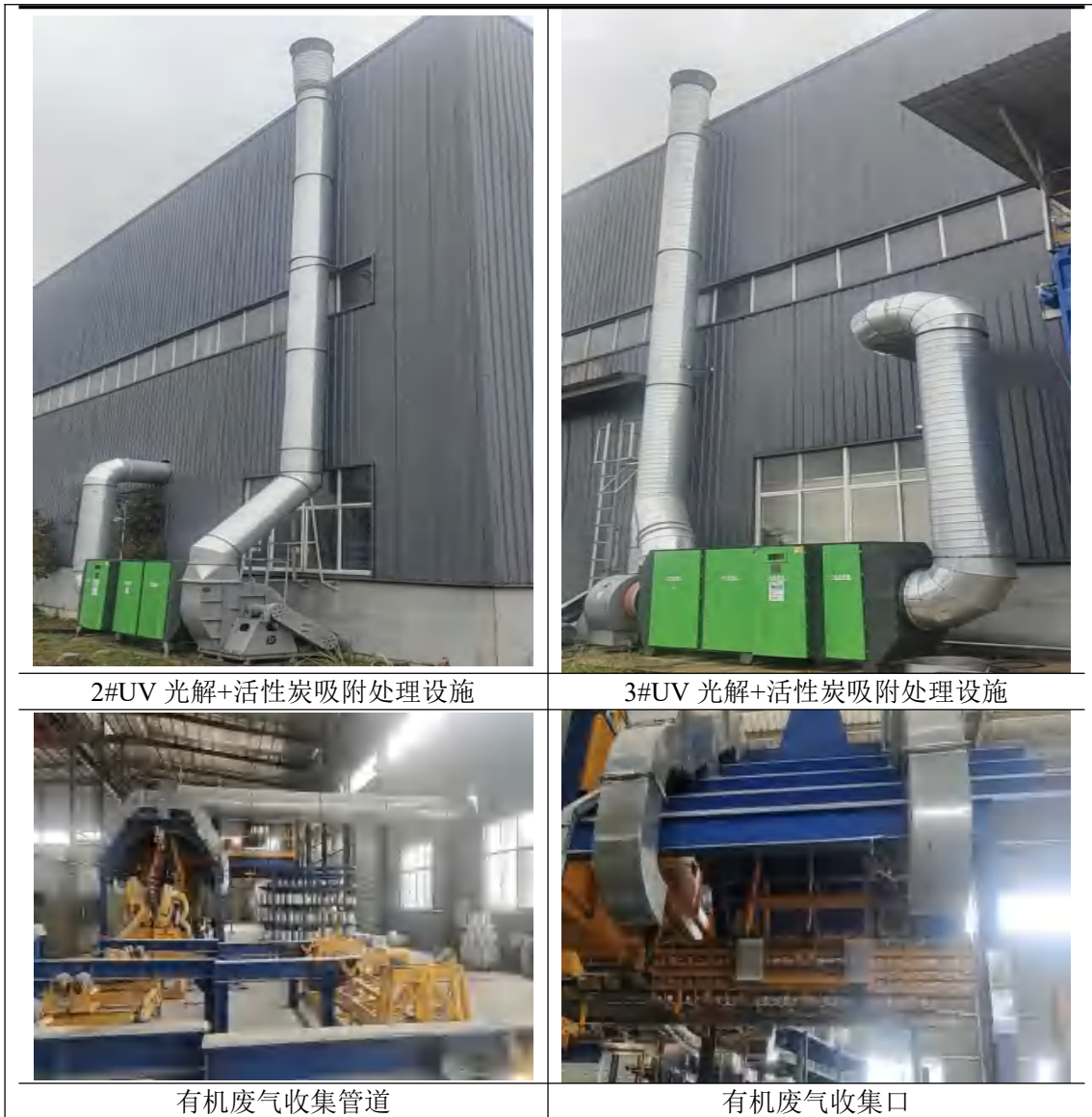
图3.2-3 相关废气处理设施照片
