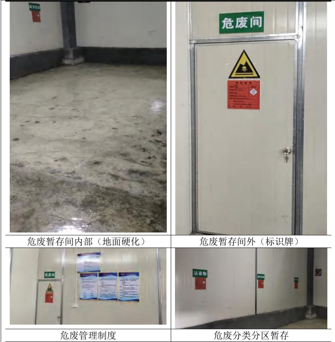
图 3.4-1 相关危险废物暂存间照片
