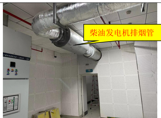
柴油发电机排气管
