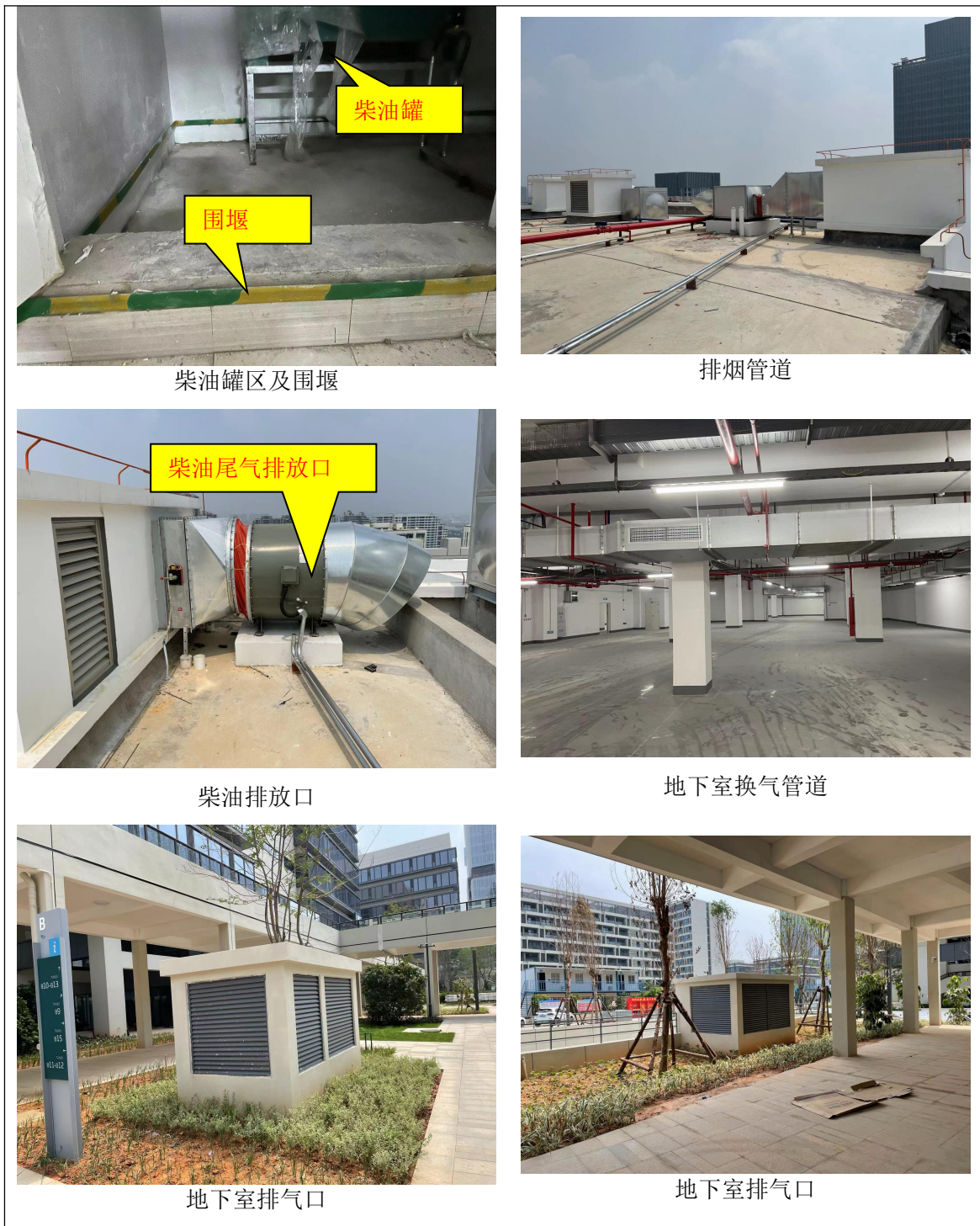
图 4-4 废气设施设置情况现场图
