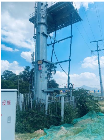
高压危险警示牌
