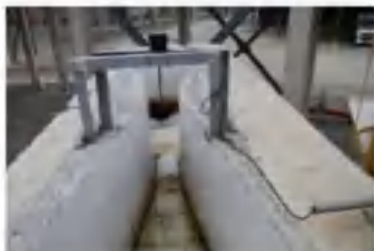
总排口计量槽（中景石化）
