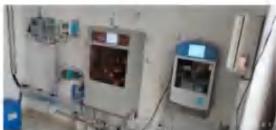
在线监控设备（中景石化）
