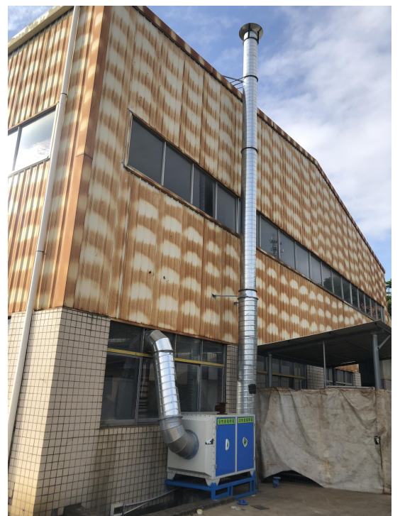
活性炭装置、15m 排气筒 (DA001)
