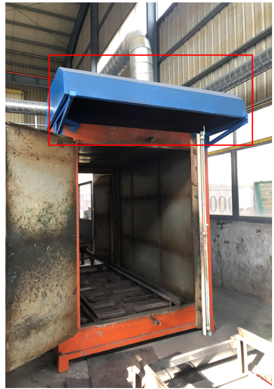
袋式除尘器、15m 排气筒 (DA001)
