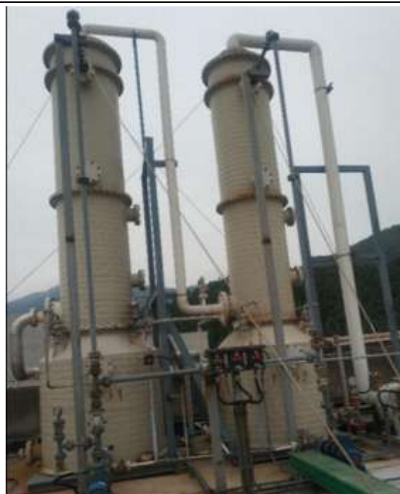
氟化锂车间废气处理设施
