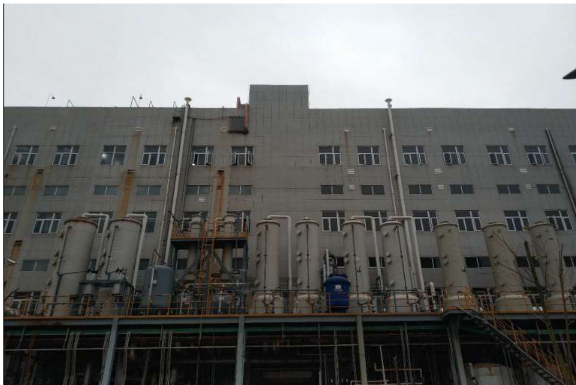
双氟磺酰亚胺锂废气处理设施
